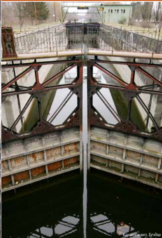
Канал и шлюз, Бездан
